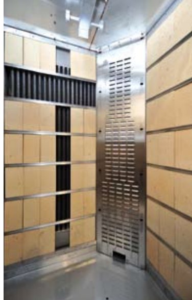
Für das Foto wurden einige Steine entfernt, so sind die Rohre gut erkennbar.
